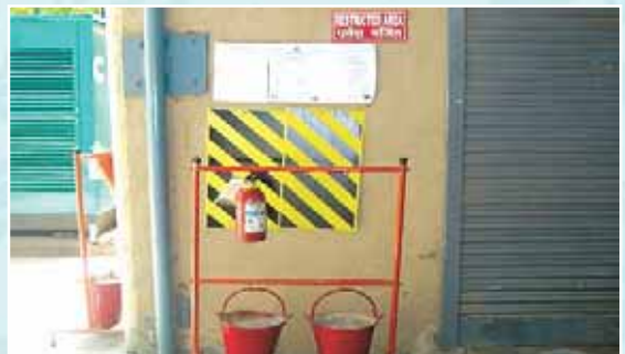
Fire-Fighting Equipment অগ্নি নির্বাপন যন্ত্রাদি
