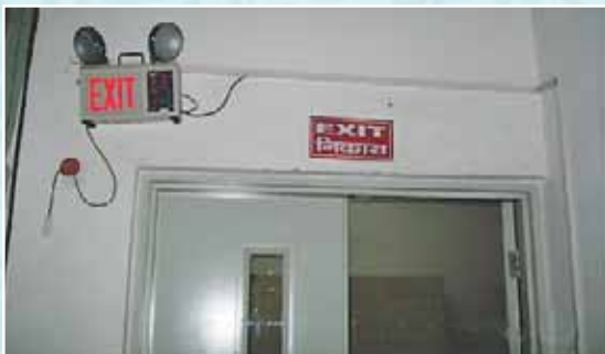
Emergency Light/ Exit Opening Outwards আপৎকালীন আলো / বাইরে প্রস্থানের পথ
